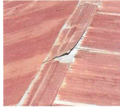
Foto 2: Sustitución de capote de lámina galvanizada por lámina troquelada aluzinc del modulo N.1
